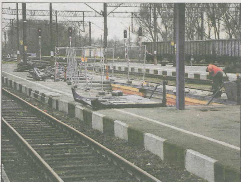
Stare wiaty były w opłakanym stanie. Niedługo na ich miejscu staną nowe
