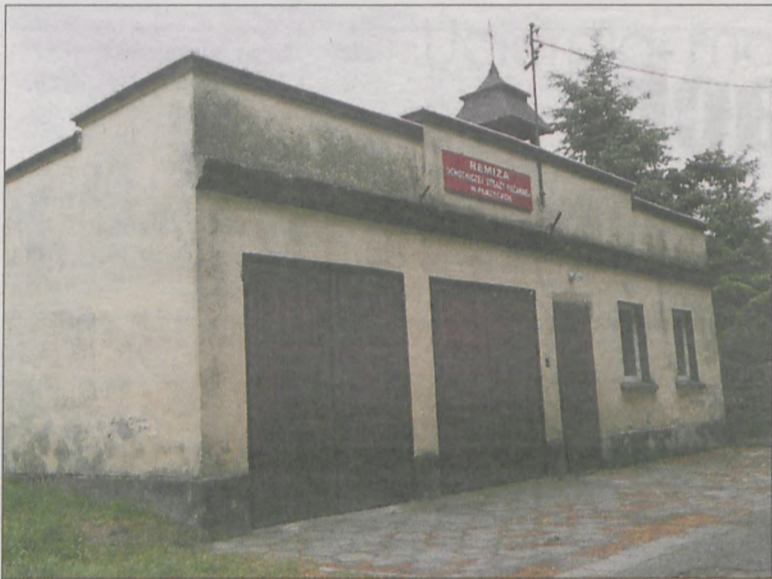
Budynek remizy jest w opłakanym stanie
