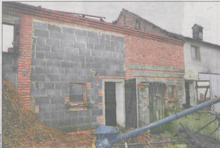
Dach spłonął doszczętnie
