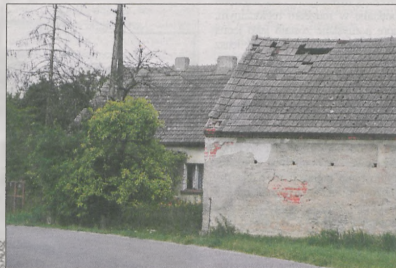
Stan budynku gospodarczego pozostawia wiele do życzenia
