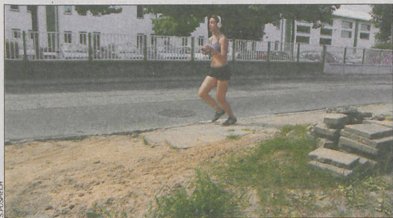
Uszkodzone płyty rozebrano 6 maja, ale wyrwa w chodniku została
