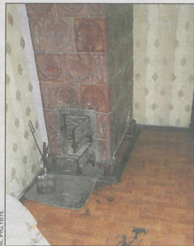
Ogień powstał prawdopodobnie przez nieostrożność domowników
