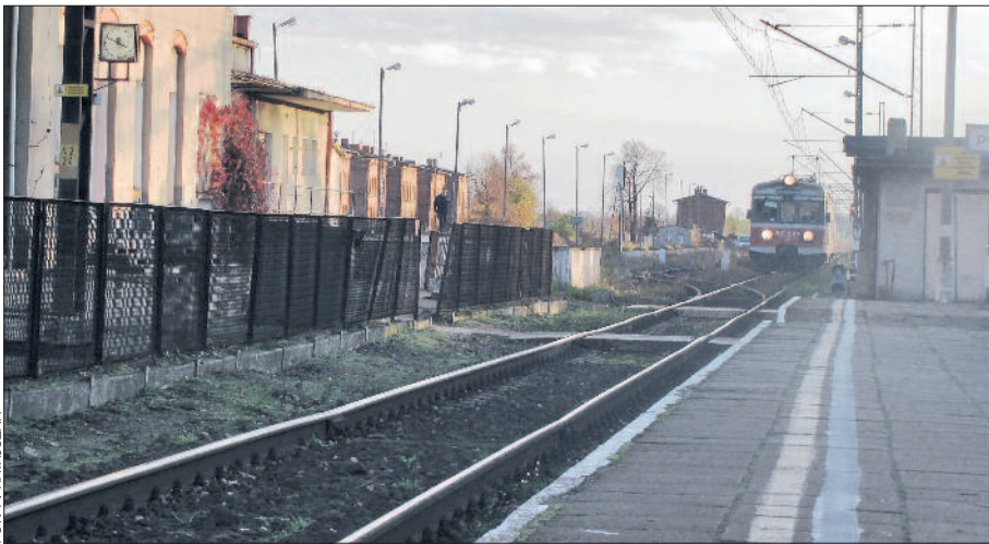
Na linii z Poznania do Piły, z powodu fatalnego stanu torowiska, pociągi muszą zwalniać obecnie do 20-30 km/godz.
