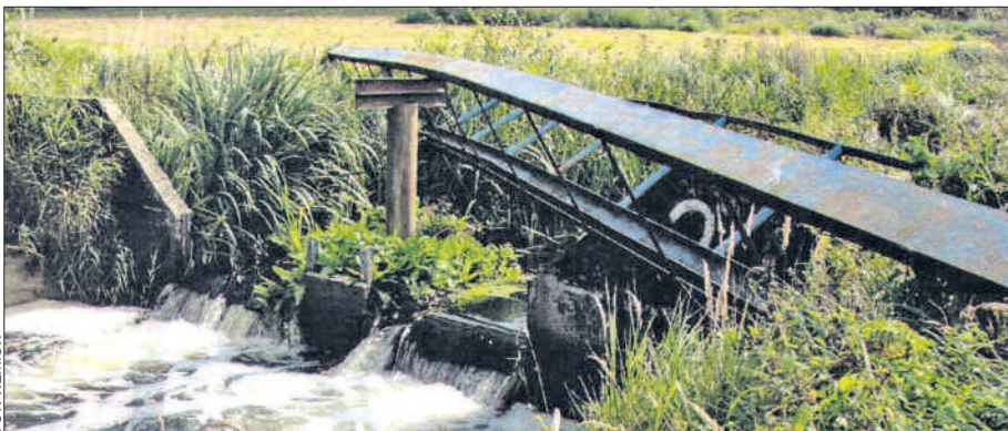
Zniszczona przez wandalę kładka na jazie na Samicy Kierskiej.
