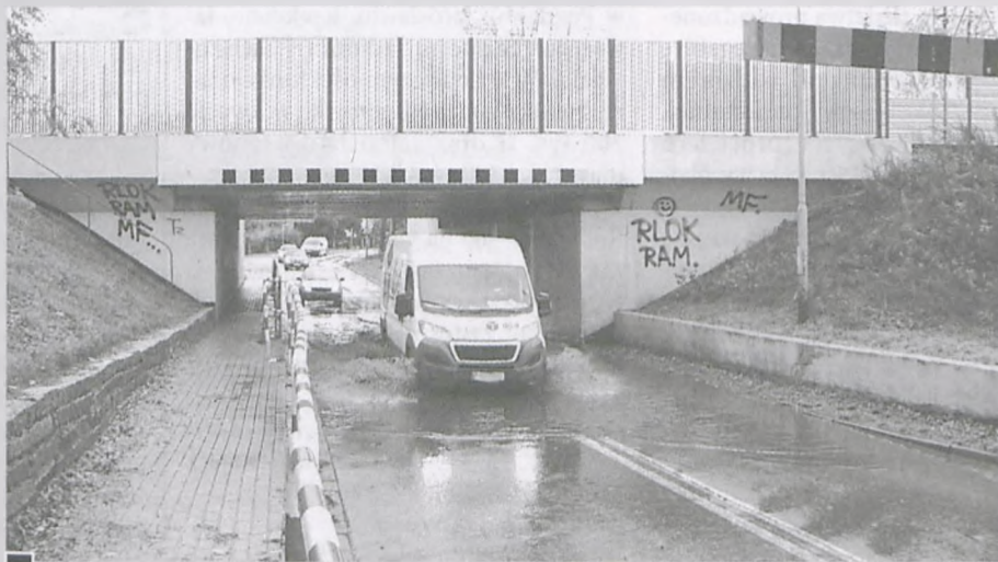
Przeprawa pod wiaduktem w ekstremalnych warunkach. Przez głębokie miejscami na pół metra bajoro przejeżdżali tylko nieliczni, większość zawracała i ruszała w objazd fot. Paweł Wolniewicz
