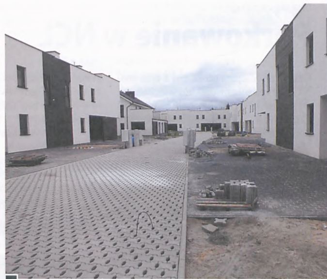
Nowe osiedle deweloperskie przy ul. Poniatowskiego 8. Na pierwszym planie budynki z czterema mieszkaniami w zabudowie bliźniaczej, w głębi „bliźniak” o długości ok. 30 metrów (szeregowiec) fot. Hanna Siatka
