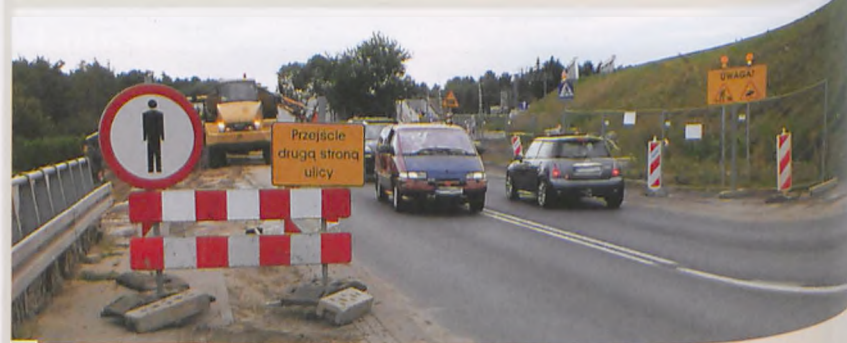
Niebezpieczna dla pieszych ulica Armii Poznań w okolicy inwestycji PKP w Łęczycy. Z lewej zamknięte dojeżdżenie do pasów; prawa strona jezdni – bez chodnika i pobocza. To m.in. droga dla podążających na pętlę autobusową przy ul. Krętej, pieszych klientów „Biedronki” przy rondzie w Łęczycy i pasażerów autobusów kursujących ulicą Armii Poznań fot. Hanna Siatka
