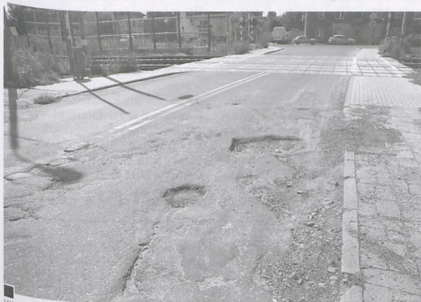
Kilkunastometrowy odcinek jezdni i chodnika pomiędzy przejazdem kolejowym a ul. Armii Poznań wymaga bezwzględnego remontu fot. Piotr P. Ruszkowski
