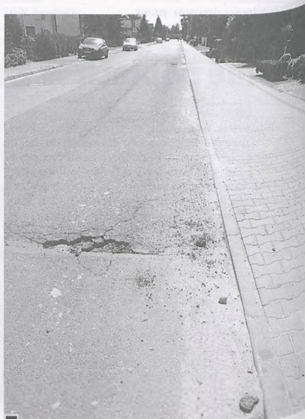
Dziura w jezdni ul. Okrzei na wysokości posesji nr 29 i 31. Widać pokruszony asfalt. Niektóre kawałki są sporej wielkości fot. Piotr P. Ruszkowski
