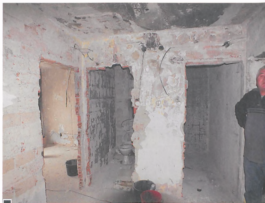
W mieszkaniu przy ul. Sikorskiego 11 trzeba było usunąć podłogi oraz skuć wszystkie tynki oraz płytki, spalone ogniem i odparzone wodą podczas gaszenia fot. Hanna Siatka
