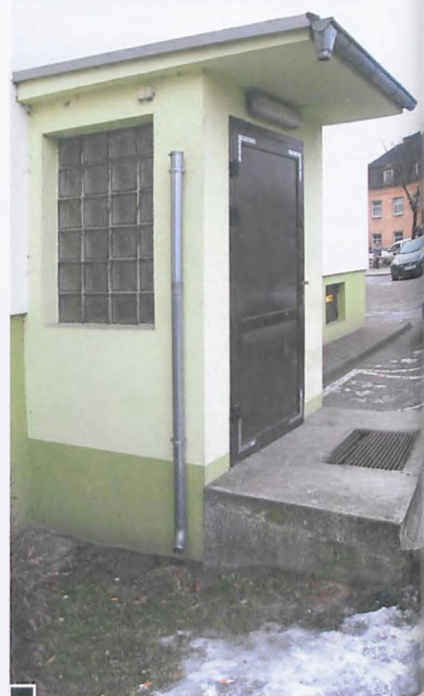
Wejście do kuchni LOSiR-u w gmachu Gimnazjum nr 1 przy ul. Dąbrowskiego ze zdemontowanym kilka lat temu fragmentem rynny spustowej fot. Piotr P. Ruszkowski
