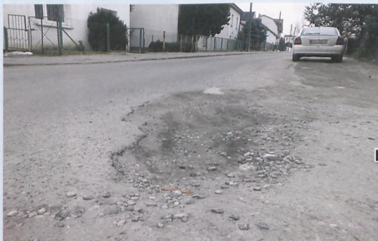
Niebezpieczna nierówność terenu przy wlocie gruntowej ul. Leśmiana w asfaltową, jednokierunkową ul. Sienkiewicza fot. Hanna Siatka
