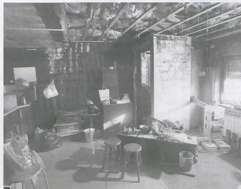
Parter domku przy ul. Świerczewskiej w niecałe dwa tygodnie po pożarze – okopcone ściany, widać zniszczoną wełnę mineralną (do wymiany), usunięto uszkodzone płyty sufitowe; z prawej – prowizorycznie zainstalowany piecyk do osuszania pomieszczeń, na środku – wygoszpowane miejsce dla zajętych sprzątaniami pogorzalców; z prawej w głębi – wydzielona z holu kotłownia, w której wybuchł pożar fot. Hanna Siatka
