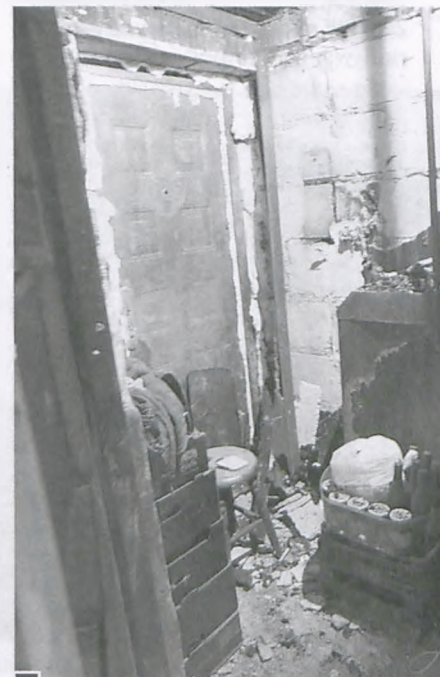
Źródło ognia w domku na działce przy ul. Świerczewskiej – niewielka kotłownia, w której znajdowało się też zasilanie w energię elektryczną. Z lewej – wyjście na zewnątrz, do drewni. fot. Hanna Siatka
