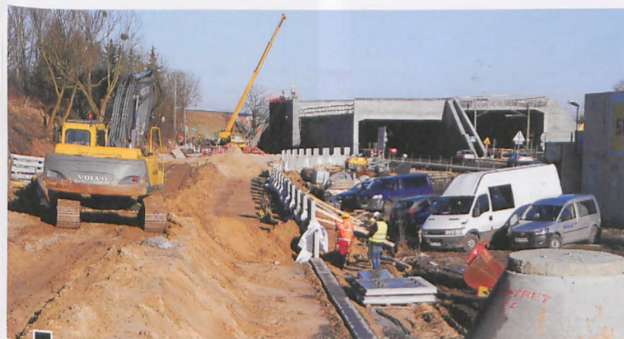
W starym miejscu trwa budowa nowej jezdni 430, która będzie się wznosić na wiadukty (tunele) w kierunku Lubonia fot. Piotr P. Ruzzkowski
