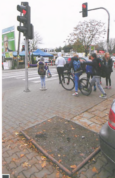
Ogrodzone krawężnikami pole po starym drzewie przy przejściu dla pieszych w drodze do SP 2. Dobrze, że chociaż wyrównane i uklepane fot. Piotr P. Ruskowski
