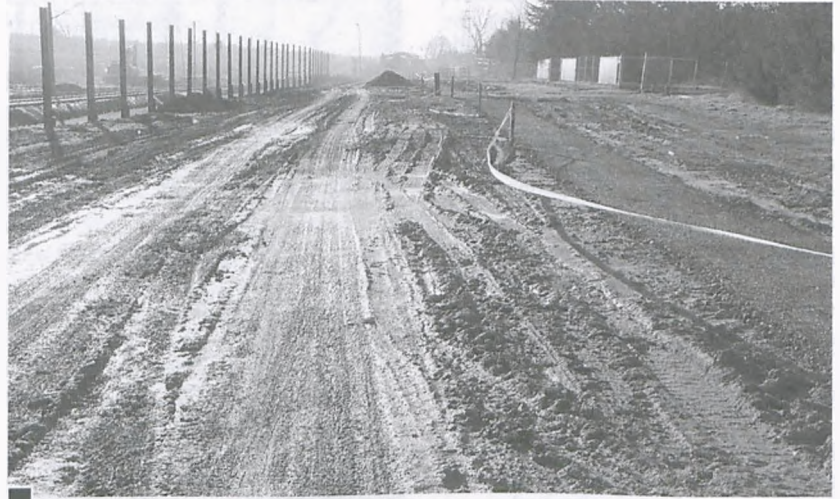
Już w miarę wyrównana, nieutwardzona ul. Dworcowa, rozjeżdżona m.in. przez ciężki sprzęt gąsienicowy. Z prawej – oddzielony taśmą „chodnik”, z lewej – słupy przyszłego ekranu akustycznego izolującego tory kolejowe fot. Piotr P. Ruszkowski
