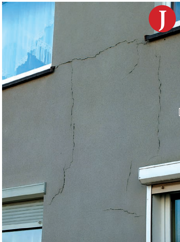
Pękające mury oddanego w 2008 r. bloku przy al. Jana Pawła II 20 (patrz mapka) pokazywały już w ub. roku („WL” 09-2015, str. 15). Dziś spękań poziomych, pionowych i ukośnych jest więcej (czytaj też „Mieszkańcy pytają” na str. 14) fot. Hanna Siatka
