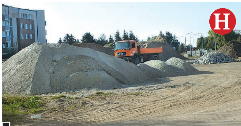
Przez wiele miesięcy – magazyn ziemi i materiałów budowlanych na gruntach przy ul. Pułaskiego wydzierzawionych przez wykonawcę ul. Wschodniej. W sprawie tego niezabezpieczonego terenu monitorują mieszkańcy osiedla (czytaj też na str. 32) fot. Hanna Siatka
