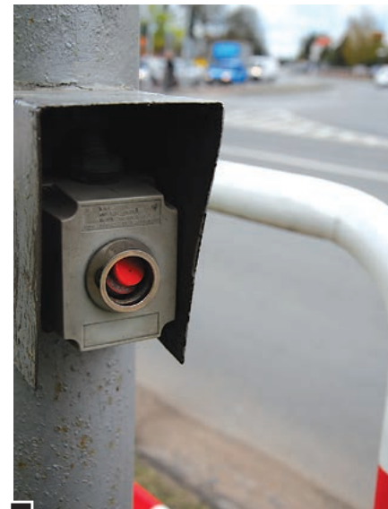
Uszkodzony przycisk sygnalizacji świetlnej naprzeciw straży OSP na ul. Żabikowskiej fot. Piotr P. Ruskowski
