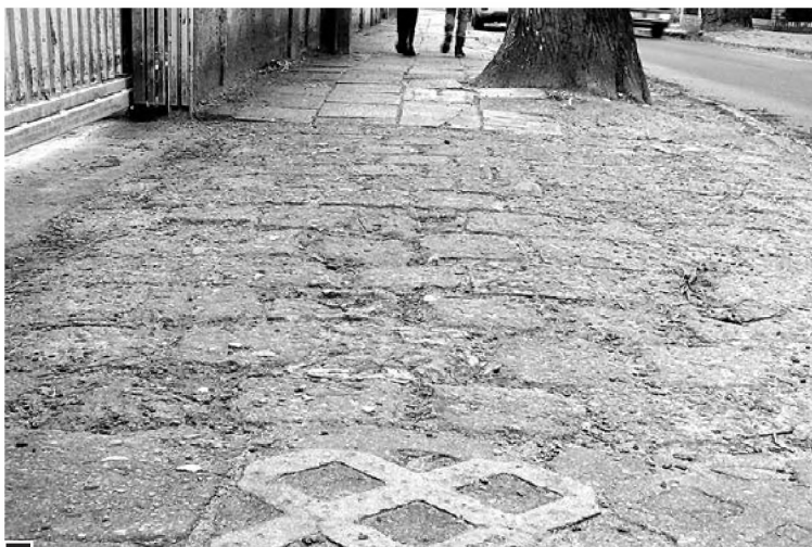
Miejsce upadku 95-lątka. Pokruszone i wystające płytki nie są oparciem dla niepewnych nóg staruszka, laski czy kuli inwalidzkiej, ani też stopy spieszącego się pełnosprawnego człowieka. Na ul. Kołtąta jest wiele takich zdewastowanych odcinków chodnika fot. Hanna Siatka
