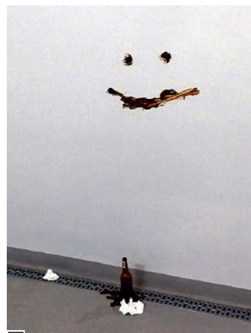
W nowym tunelu przejścia podziemnego pomiędzy peronami dworca w Luboniu ktoś posmarował ekskrementami ścianę. Czy to manifest w związku z brakiem toalet w tym publicznym miejscu? fot. Jakub Słomczyński
