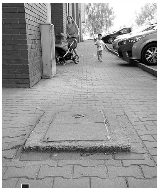
Studzienka telekomunikacyjna w chodniku ul. Wschodniej niebezpiecznie wystająca z chodnika fot. Piotr P. Ruszkowski
