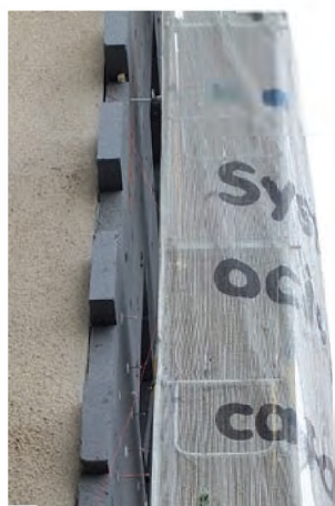
Fragment docieplanej ściany budynku przy ul. Sikorskiego 31. Użyto styropianu gątfowego – bardziej odpornego na tzw. samozapalenie fot. Hanna Siatka
