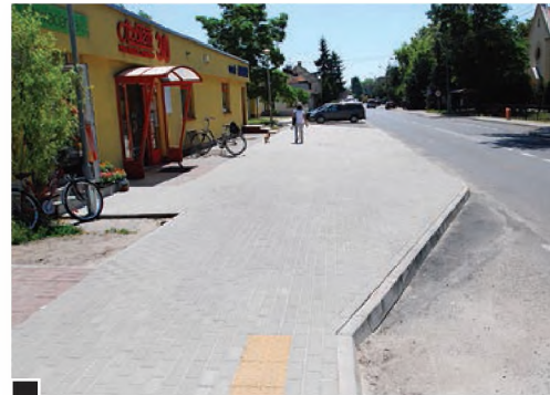
Nadmiernie szeroki pas odnowionego chodnika należało w części przeznaczyć na przedłużenie pasa parkingowego lub zabezpieczyć przed wjeżdżaniem rzędem barierek fot. Piotr P. Ruszkowski
