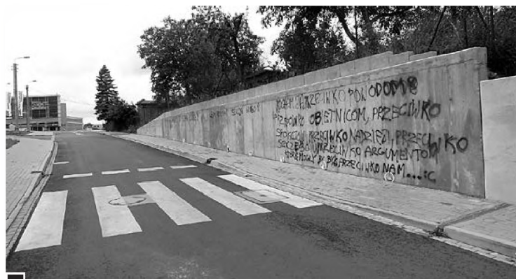
Zniszczona sprayem ściana oporowa przy ul. Paderewskiego fot. Hanna Siatka
