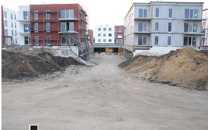
Dotychczasowy, dostatecznie już utwardzony przez ciężki sprzęt dojazd na budowę od strony ścieżki rekreacyjnej łatwo może przekształcić się w normalną jezdnię fot. Piotr P. Ruszkowski
