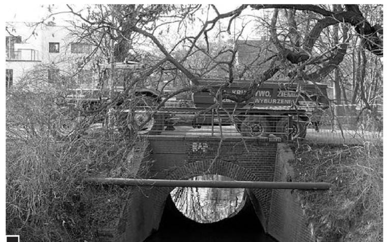
załadowany ciągnik stanowi duże obciążenie dla starego, „zmęczonego” mostu fot. Paweł Wolniewicz
