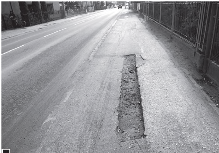
Niebezpieczna, szczególnie po zmroku, dziura na środku chodnika ul. Sobieskiego fot. Władysław Szczepaniak
