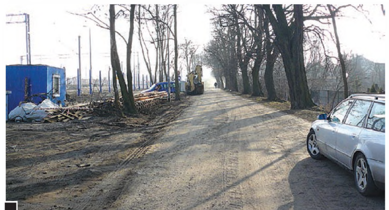
Chciałoby się rzec, że po wykonawcy – jak na polu bitwy – pozostał tylko kurz i pył. Chętnie uczęszczany przez spacerowiczów deptak ciągnący się od wiaduktu przy ul. Powstańców Wlkp. w kierunku dworca jest w całości pokryty warstwą piachu, ziemi i błota fot. Paweł Wolniewicz
