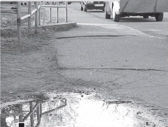
Zły stan chodnika na ul. Osiedlowej w okolicy Żabinki – błoto, pęknięcia i poprzeczne wycięcia w asfalcie, a w głębi (przy barierze ochronnej) wyniesienie nawierzchni, o które potykają się piesi fot. Hanna Siatka
