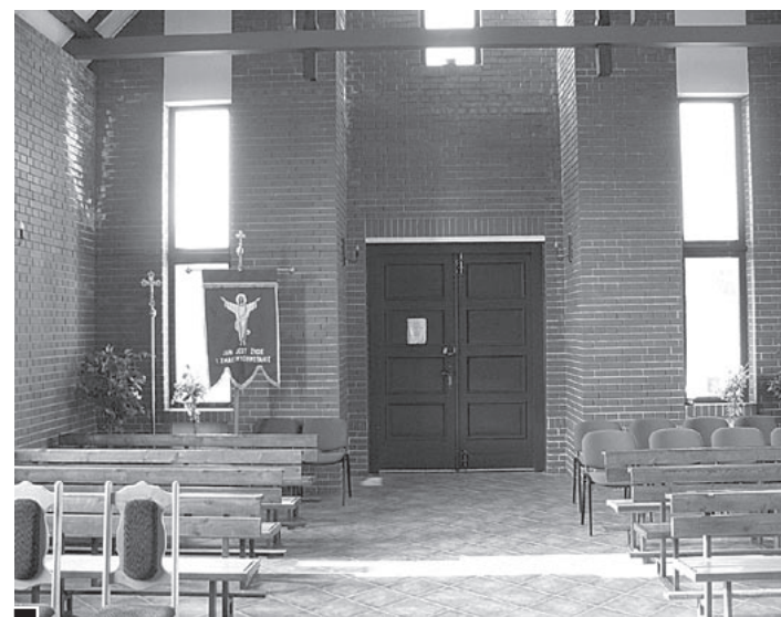
Ławki kościelne nadały cmentarnej kaplicy bardziej sakralny i estetyczny wygląd. Z lewej u góry, w narożniku, wyraźnie widoczne siwe zaciek na klinkierowej cegle budynku oddanego do użytku w połowie 2005 r. – fot. Paweł Wolniewicz
