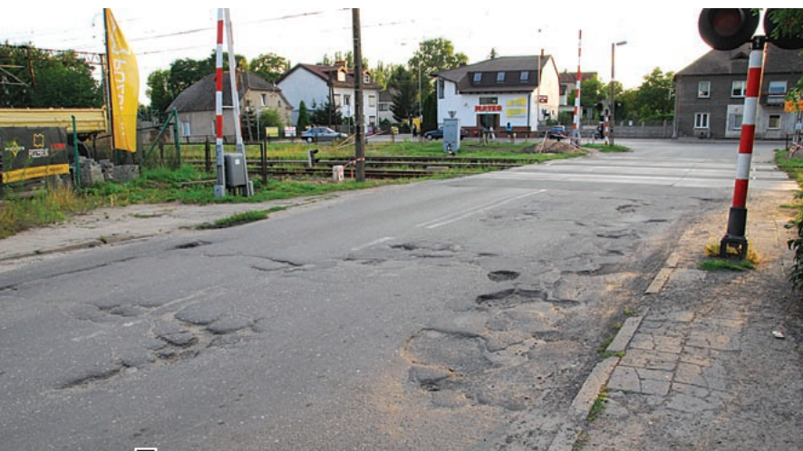
Różnice poziomu asfaltu na przejeździe kolejowym przy Zakładach Ziemniaczanych sięgają kilkunastu centymetrów fot. Piotr P. Ruszkowski
