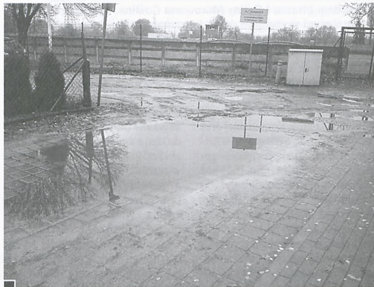
Odcinek ul. Dąbrowskiego leżący za ul. 3 Maja (prostopadły do stadionu) został niedawno utwardzony pozbrukiem. Jak widać na zdjęciu, zastosowany system odwodnienia nie jest skuteczny fot. Marta Pniewska
