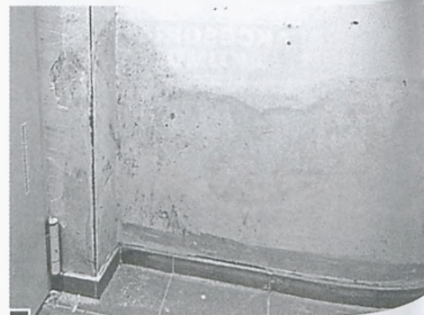
Ślady po wilgoci na ścianach w podziemiu fot. Katarzyna Polerowicz-Kelma
