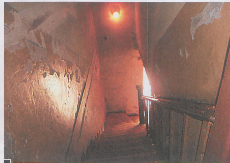
Ogólny widok klatki schodowej, którą miasto nie zajmowało się od czasu przejęcia budynku po cegielni fot. Władysław Szczepaniak
