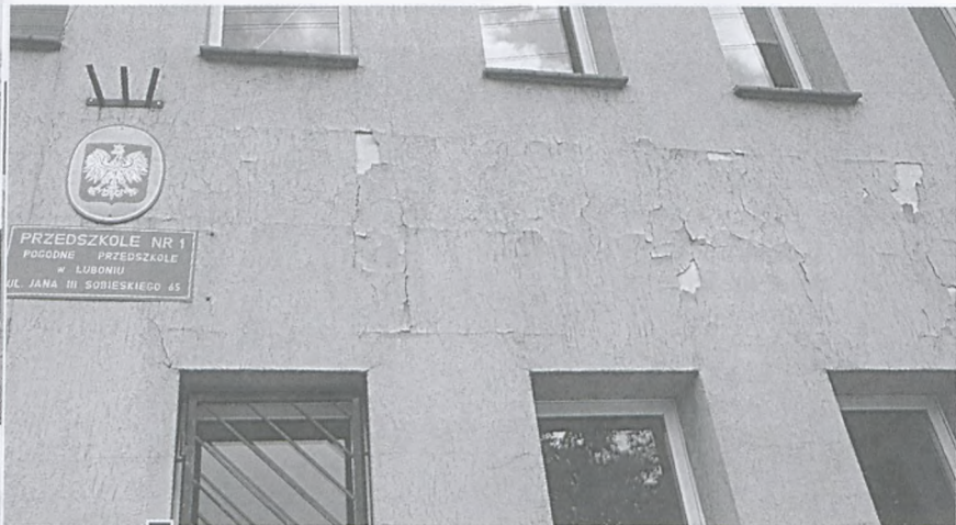
Spękana frontowa elewacja Przedszkola Publicznego przy ul. Sobieskiego 65, na której można liczyć płyty styropianowe fot. Piotr P. Ruszkowski
