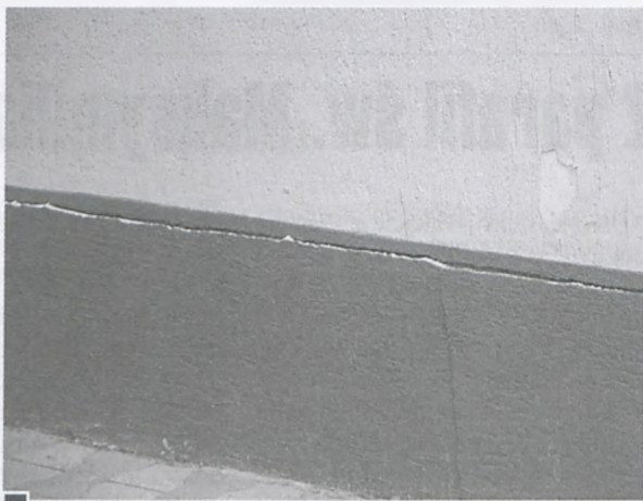
Wyraźny błąd w sztuce. pęknięcie pomiędzy częścią przyziemia a resztą elewacji, gdzie małe dzieci mogłyby z powodzeniem wsadzić palce fot. Piotr P. Ruszkowski
