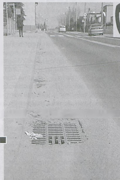
Takie ilości piachu podczas ulewnego deszczu mogą zapchać nową kanalizację fot. Piotr P. Ruszkowski
