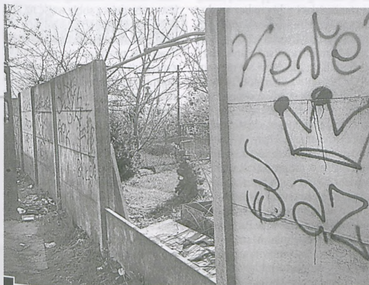
niszczone ogrodzenie ROD „Bratek” od strony przesymskiego przy parkingu wzdłuż ul. Unijnej fot. Jan Błaszczak
