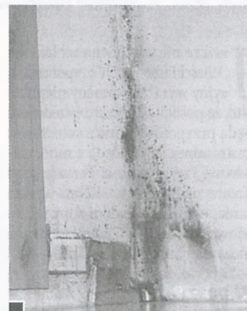
Pleśń na ścianie kuchennej w bloku przy ul. Żabikowskiej 50
