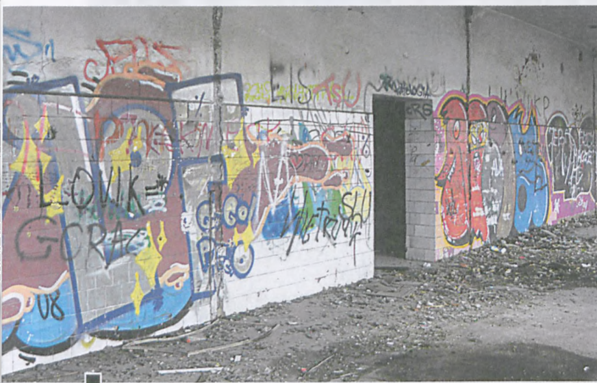
Pustostan przy ul. Granicznej (była firma „Inter-smak”), wewnątrz którego znajdują się kolorowe graffiti fot. Paulina Sawicka
