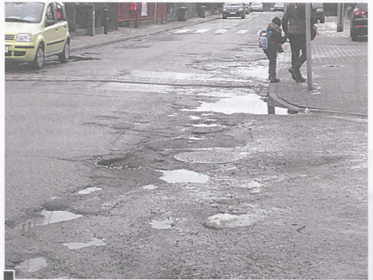
Stan nawierzchni asfaltowej na ul. 1 Maja, przy której znajduje się Szkoła Podstawowa nr 4. Kierujący pojazdami poruszają się środkiem drogi, gdyż największe dziury znajdują się przy krawężnikach fot. Paulina Sawicka
