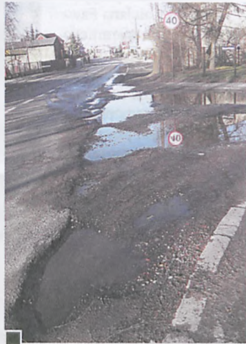
Fatalny stan wylotu gruntowej ul. Kurowskiego w jedną z głównych ulic w Luboniu – Sobieskiego fot. Paulina Sawicka
