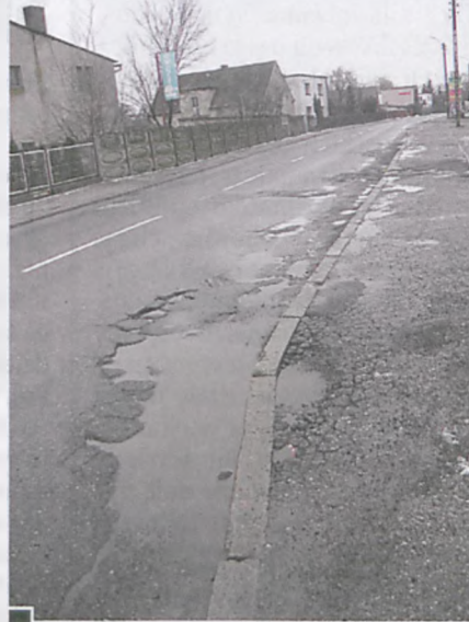
Popękana i dziurawa nawierzchnia asfaltowa jednej z głównych ulic w Luboniu – ul. Sobieskiego na wysokości Centrum Handlowego „Venus” fot. Paulina Sawicka
