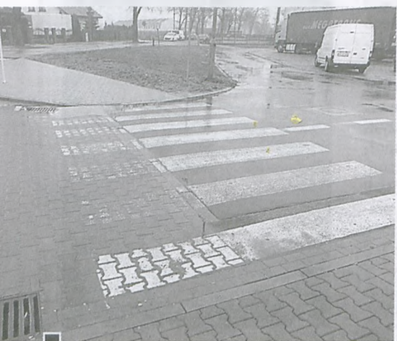
Zaledwie po miesiącu eksploatacji powycierane przez pojazdy oznakowanie poziome, szczególnie na kostce brukowej i skrzyżowaniu Poznańskiej z Targową i Buczka fot. Rafał Wojtyniak
