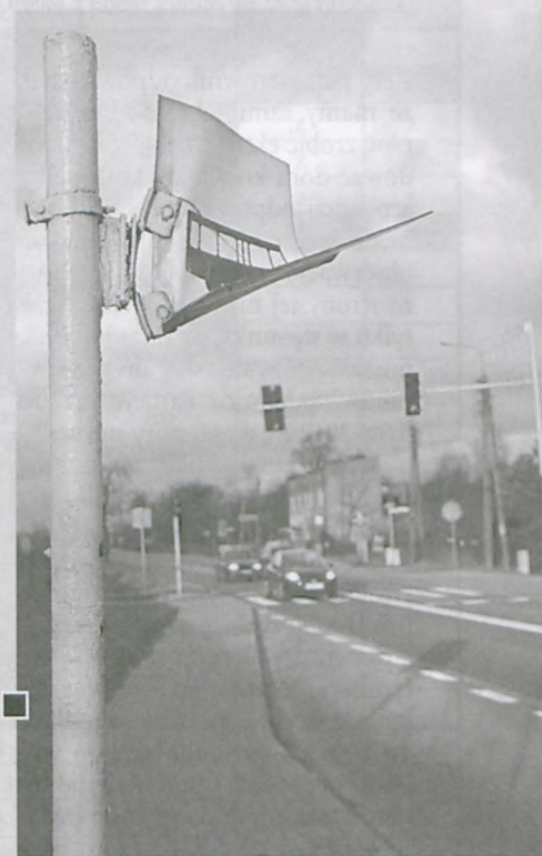
Wygięty w formie minizadaszenia znak drogowy na przystanku autobusowym fot. Piotr P. Ruszkowski
