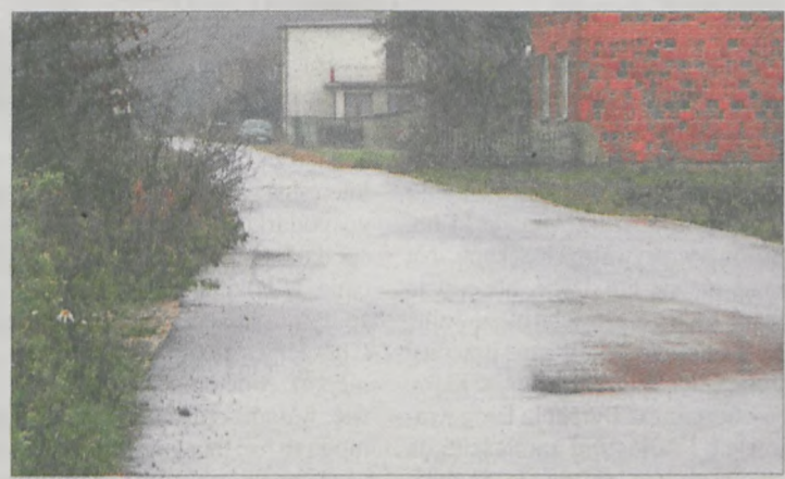
Nierówny asfalt sprawia, że jadąc samochodem, pojazd przechyla się na boki
