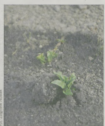
Chwasty rosną na asfaltowej drodze w Parzęczewie oddanej do użytku na początku września
