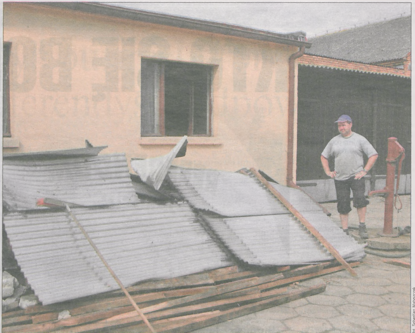
Tak wyglądał po wichurze dach z domu Wiesława Szymczaka z Cerekwicy Starej
