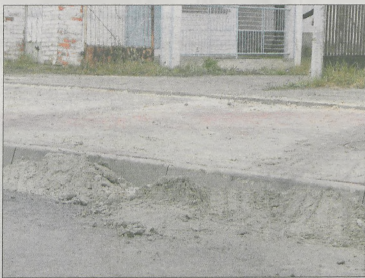
Niewygodne uskoki mają zniknąć po wylaniu kolejnych warstw asfaltu
