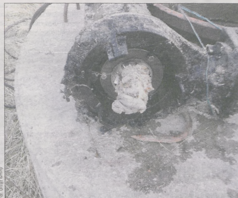
To zdjęcie zostało zrobione na przepompowni na ulicy Leśnej w Boguszynie
