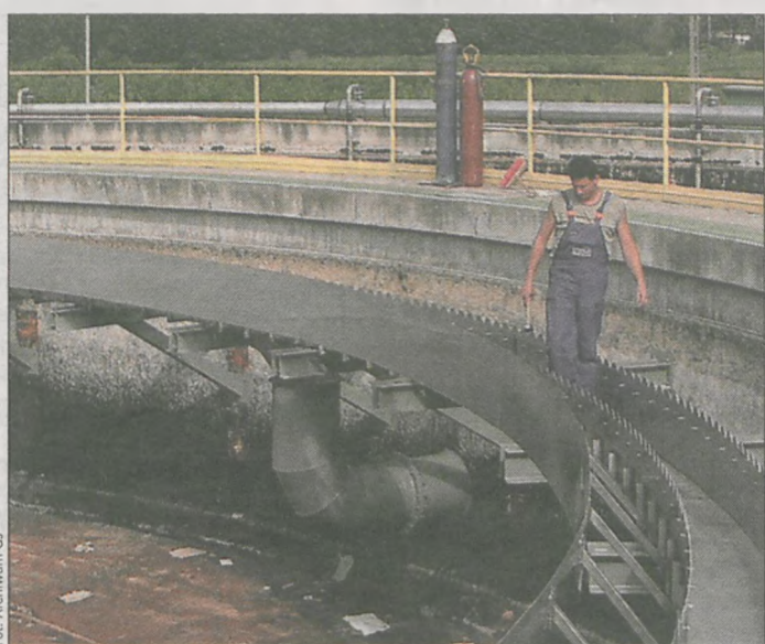
Oczyszczalnia ścieków w Cielczy
