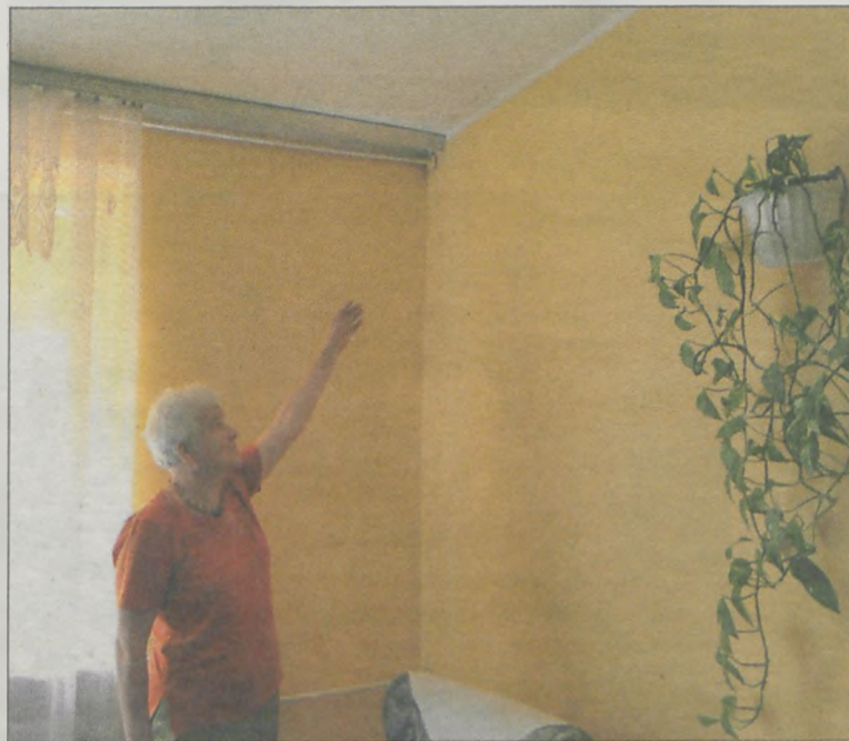
Krystyna Mańkowska mówi, że przez ostatnie dni wietrzyła i suszyła ściany swojego mieszkania i tylko dzięki temu widoczne zacieki to tylko niewielka pozostałość po tym, co było tam jeszcze tydzień temu
