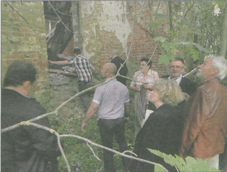
Kretków: Zdewastowana część pałacu wymaga zabezpieczenia
