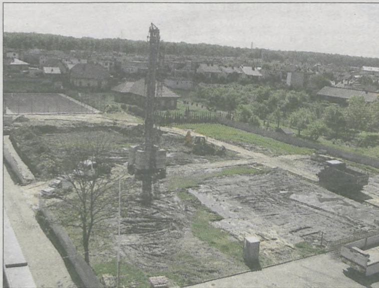
Na plac budowy przy jarocińskiej „dwójce” został już sprowadzony ciężki sprzęt. Pierwszy etap inwestycji ma być zakończony jeszcze w tym roku
