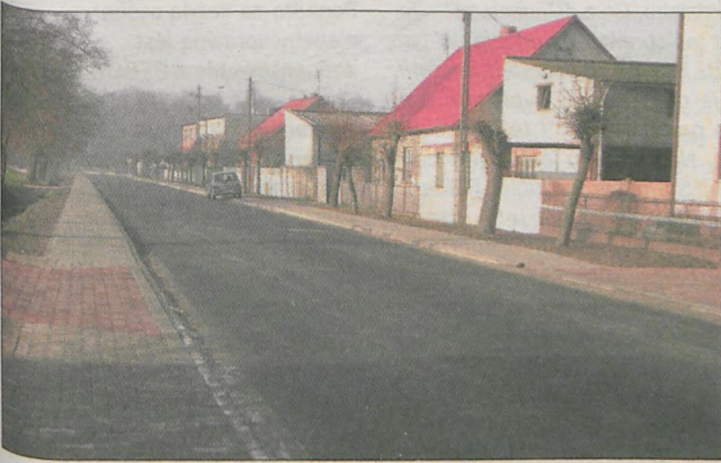
Nie ma wątpliwości, że remont ulicy Dworcowej w Golinie jest wykonany źle. Teraz chodzi o to, żeby ktoś rzetelnie ocenił, co tam trzeba poprawić - powiedział „Gazecie” przewodniczący rady powiatu Zygmunt Meisnerowski i zażądał niezależnej ekspertyzy wykonania inwestycji
