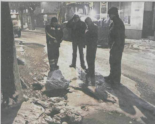
Chwilę po zgłoszeniu na miejscu pojawia się pierwsza ekipa z Kanbudu. Za nią kolejni robotnicy ze sprzętem. - Trzeba będzie rozkopać - wyrokuje szef Pogotowia Wodociągowego.
