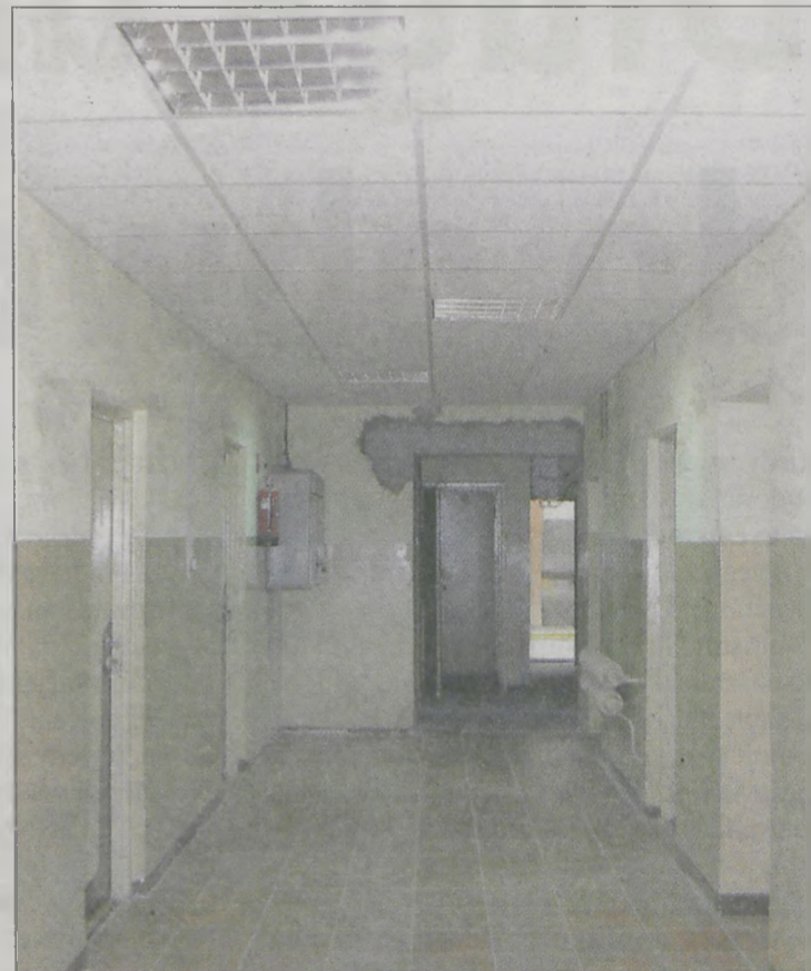
W korytarzu budynku biurowego obniżono sufit i wykonano nową podłogę oraz oświetlenie. Do pomalowania zostały jeszcze ściany
