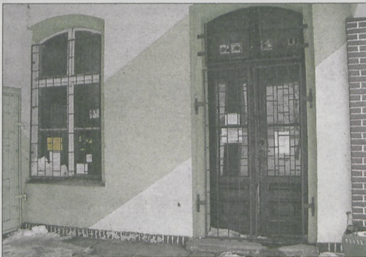
(era) POCZEKALNIA NA STACJI PKP w Kotlinie jest zamknięta na kłódkę
