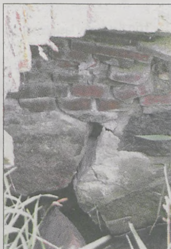
MOSTEK W KOLNICZKACH został uszkodzony jesienią zeszłego roku. Od tamtego czasu trwa korespondencja między gminą Nowe Miasto a firmą ubezpieczeniową
