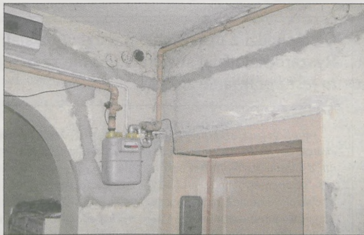
LOKATORZY SKARŻĄ SIĘ na zły stan klatki schodowej
