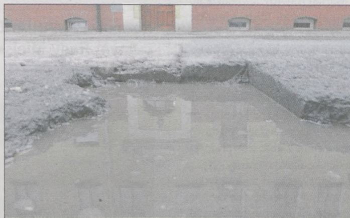
UL. DĄBROWSKIEGO W JAROCINIE, przy wjeździe do drukarni jest głęboka i niebezpieczna dziura.
