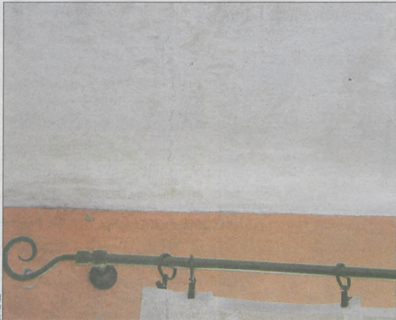
Zacieki na suficie w jednym z pokoi
