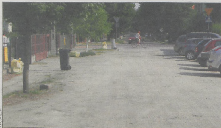
Droga od skrzyżowania z ul. Staszica jest wyboista
