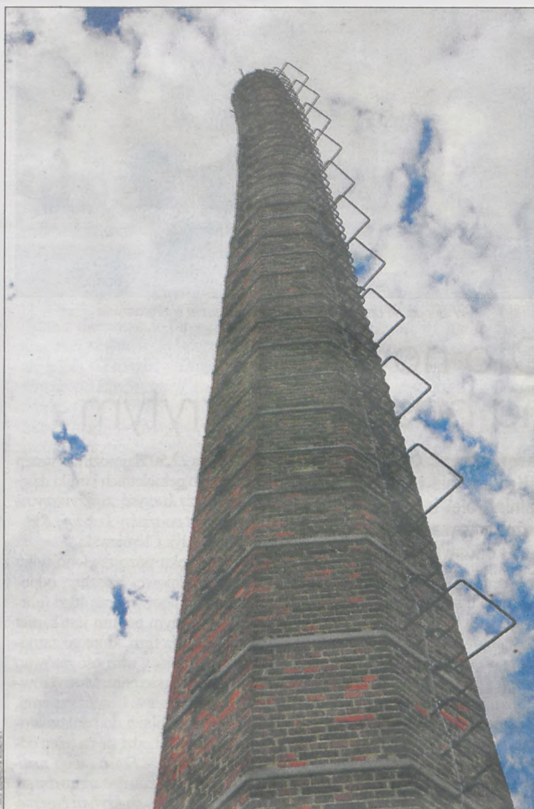
Komin jest wyraźnie przechylony w swej szczytowej części
