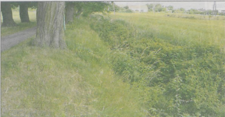
Rów melioracyjny czeka na modernizację
