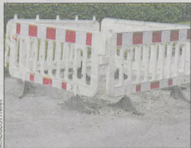
Zapadnięta studzienka na drodze została ogrodzona
