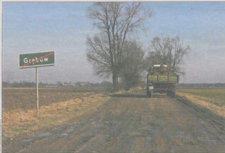
Droga wytrzymała tylko cztery miesiące. Dziś na powrót nadaje się do remontu
